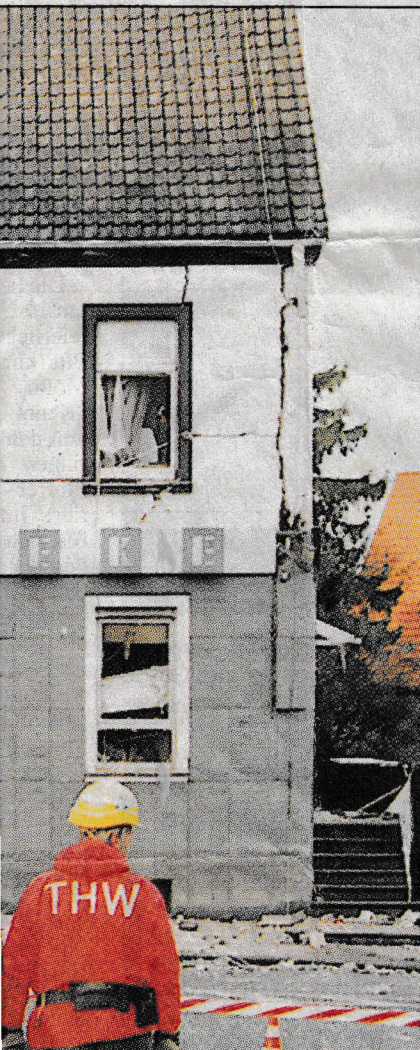
urde durch die Explosion total zerstört, organen für die Sicherung des Gebäudes. Fotos: Michael Görg
